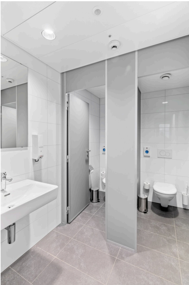
WC-Anlage auf der Mietfläche
